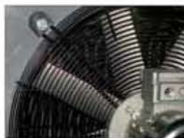
Detalle del ventilador.
